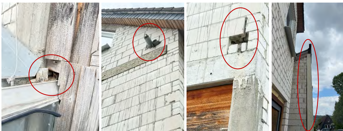
Abb. 17: Marode und abstehende Holzvertäfelungen, unverputzte Fassaden, zerbrochene Hohlblocksteine in der Außenfassade oder offene Rohrleitungen und Schächte bieten sowohl gebäudebewohnenden Vogelarten als auch Fledermäusen optimale Lebensräume
