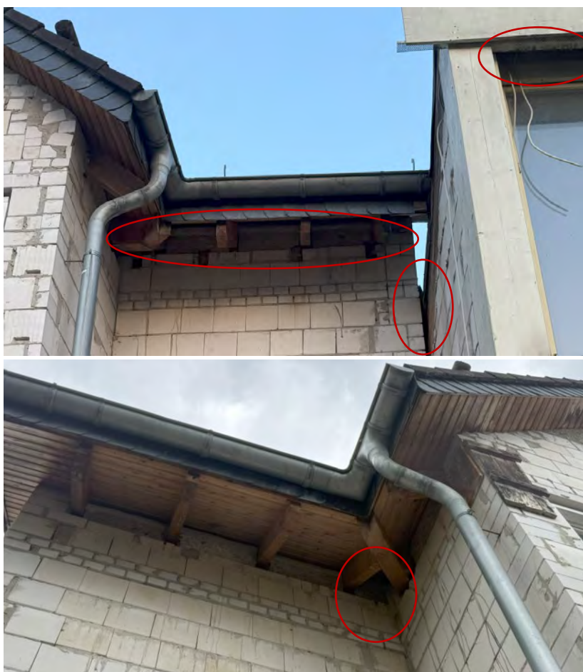
Abb. 18: Offene Nischen im Bereich des Dachüberstandes bieten weitere Versteckmöglichkeiten für gebäudebewohnende Tierarten. Im unteren Bild deuten Kotspuren an der Fassade bspw. auf eine aktuelle Nutzung hin
